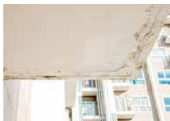
Infiltration d'eau dans la dalle
