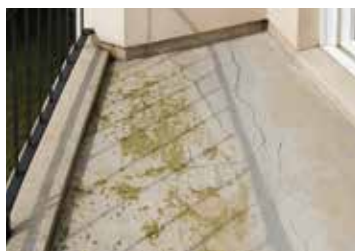
Encrassement et fissures
