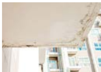
Infiltration d'eau dans la dalle
