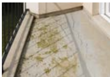
Encrassement et fissures
